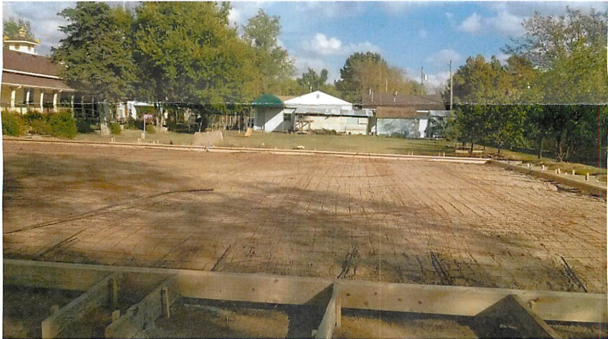
Nền móng Hội trường chuẩn bị đổ bê tông 120 Feet dài, 40 feet rộng
